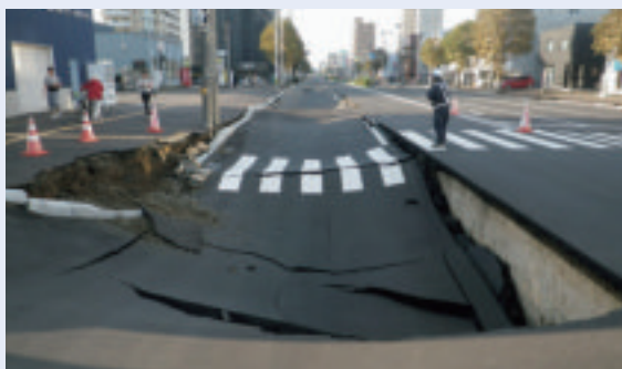
東 15 丁目・屯田通の道路陥没
